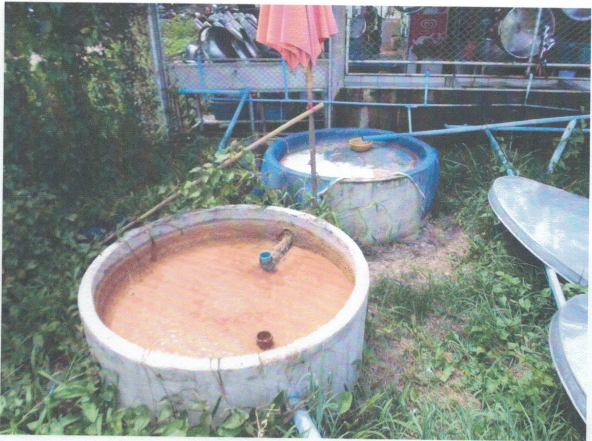
บ่อบำบัดน้ำเสีย โรงเรียน
