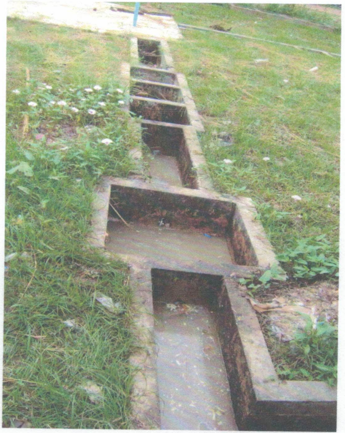
รางส่งน้ำจากโรงครัวสู่บ่อซีเมนต์รับน้ำเสีย
