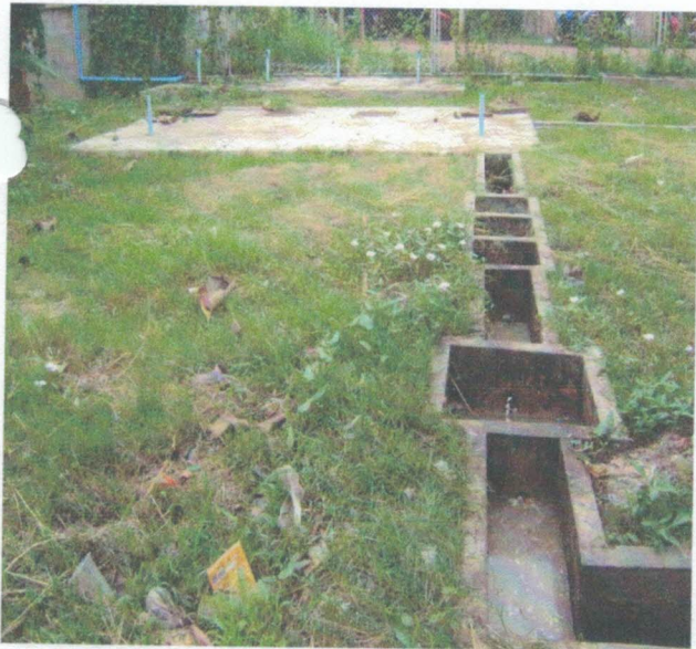
รางส่งน้ำจากโรงครัวสู่บ่อซีเมนต์รับน้ำเสีย
